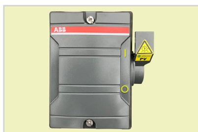
1. CONTROLEER OF DE WERKSCHAKELAAR NAAST DE OMFORMER OP "1" STAAT.
