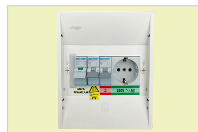
3. ALS ER EEN ONDERVERDEELKAST AANWEZIG IS, CONTROLEER DAN DE AUTOMATEN HIERIN
